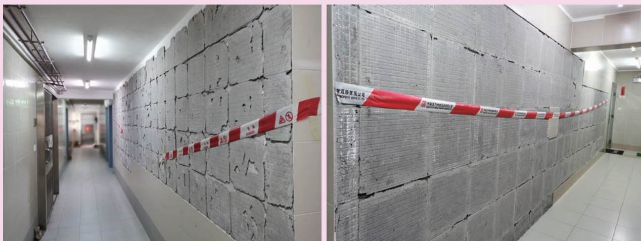
Registaram-se casos de queda de azulejos de grande dimensão nas diferentes partes das paredes de dois empreendimentos de habitação económica, um no Edifício do Lago, na Taipa, e outro no Edifício Ip Heng, em Coloane
